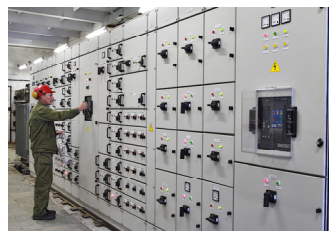
受変電設備異常検知
